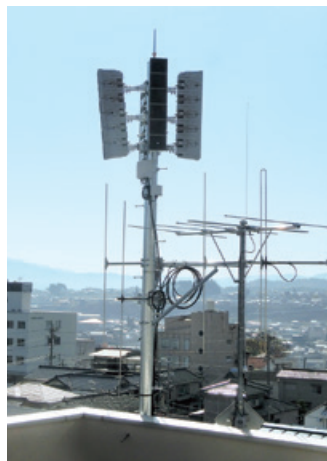
飯田市役所屋上設置の屋外子局
