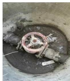
富士通中央空調(無錫)の支水管に設置した弁
