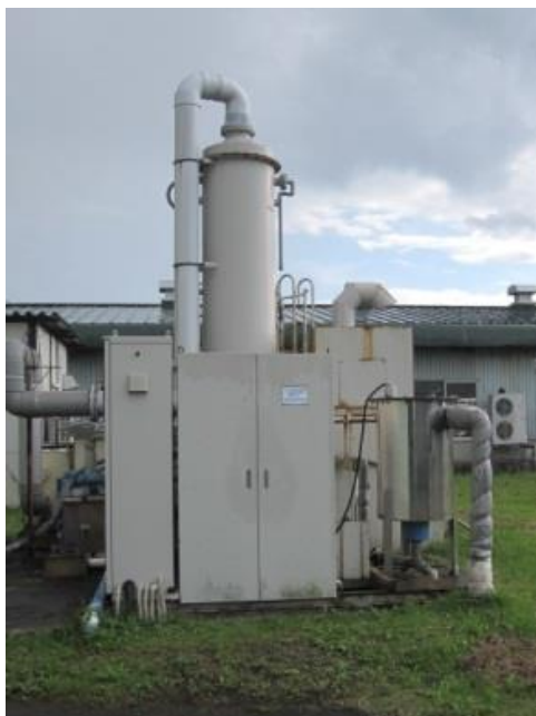
地下水浄化装置（青森事業所）
