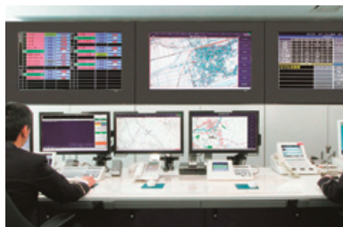
消防システム
