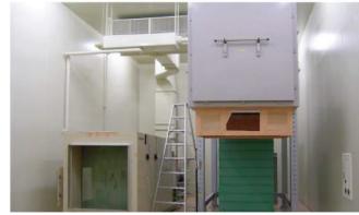
風量測量室 測量家用及商用空調的風量。
