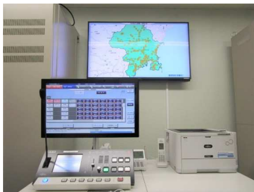
下田市様の防災行政無線システム操作卓
