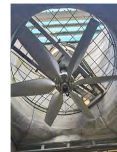
冷却塔の軽量プラスチックファン
