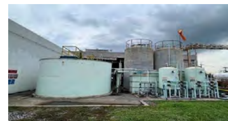
化学廃水処理設備 (FGT)
